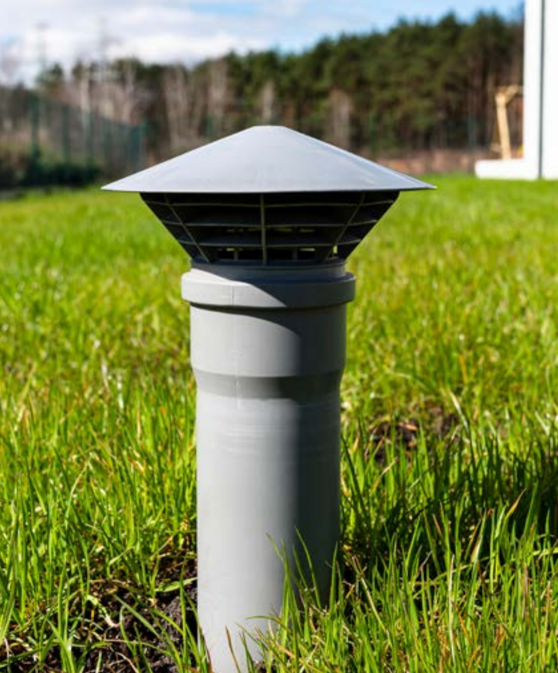
Fot. 7. Wyprowadzenie nad powierzchnię terenu kanału napowietrzenia w oczyszczalni drenażowej - na końcówkach nitek nitek drenażowych.
